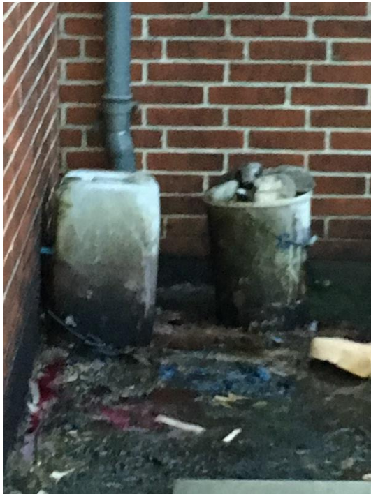
Afløb fra kompressor til beholder
