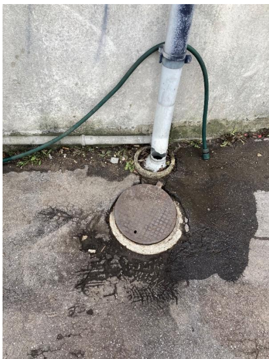
Figur 2 Brønd med utæt belægning og defekt nedløbsrør
