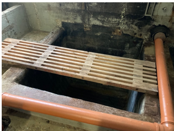
Spildevandsrummet – de nedgravede kar var tomme
