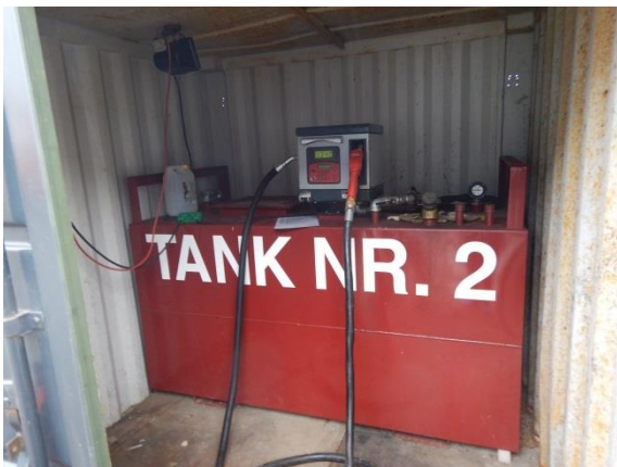
11. Dieseltank i lukket container.
