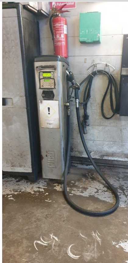
Påfyldningsanlæg for diesel i vaskehallen
