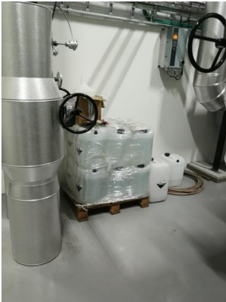
Billede 1. Oplag af dunke i pumperummet.
