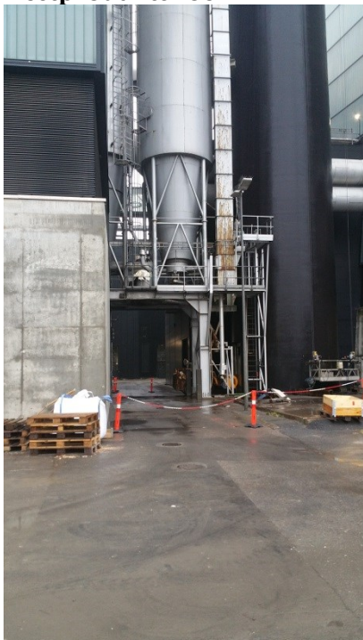
Restproduktsiloer til restprodukter fra affaldsforbrænding. Ingen synlige rester af spild i området omkring.
