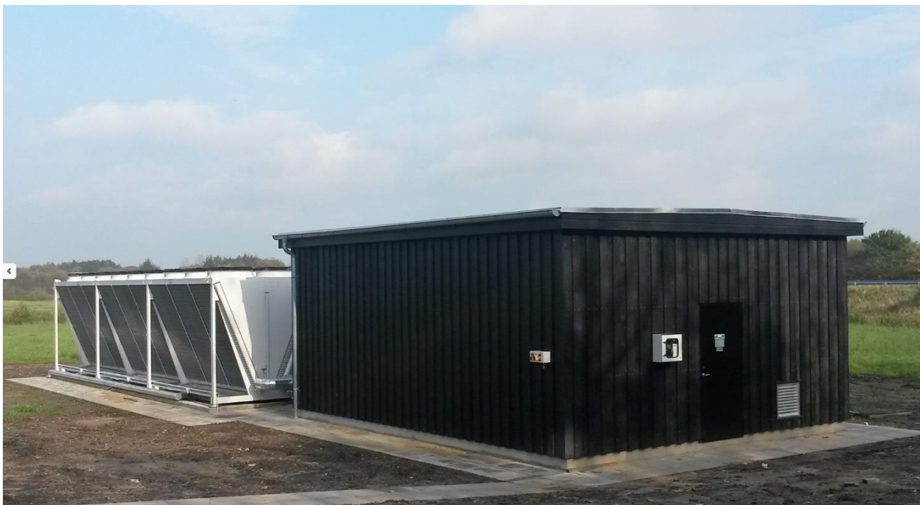
Figur 1: Varmepumpeanlæg ved Sig Varmeværk. Billede fra Tjæreborg Industri.
