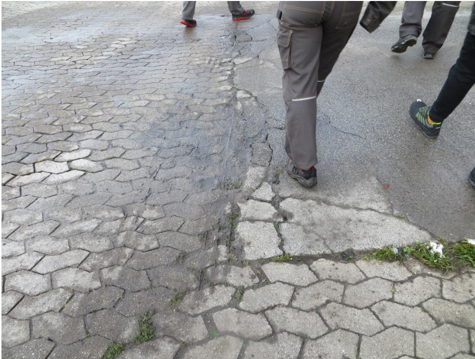
Belægning er flere steder i dårlig forfatning og er ikke tæt. Mest risiko for forurening af jord og grundvand med organisk materiale. Der vil komme generelle vilkår om jævnlig vedligehold af belægninger i revurderingen.
