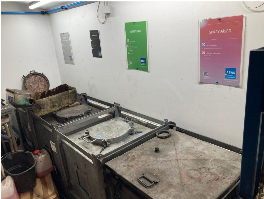
Affaldssortering i tankcontainere. Containerne leveres og håndteres af ABAS og sorteringsvejledningen er tydeligt skiltet for hver enkelt container. Tankcontainerne er placeret i samme "grav" som resten af det flydende olie- og kemikalielager.
