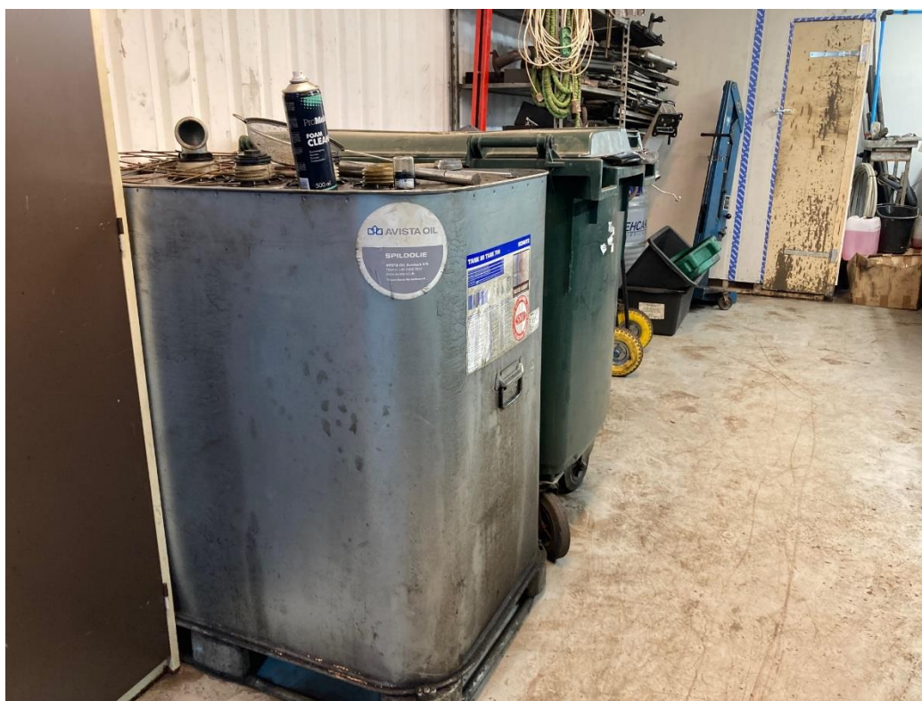
Avista-spildolietank placeret i "grav" på epoxygulv. Der er intet afløb i gulvet.
