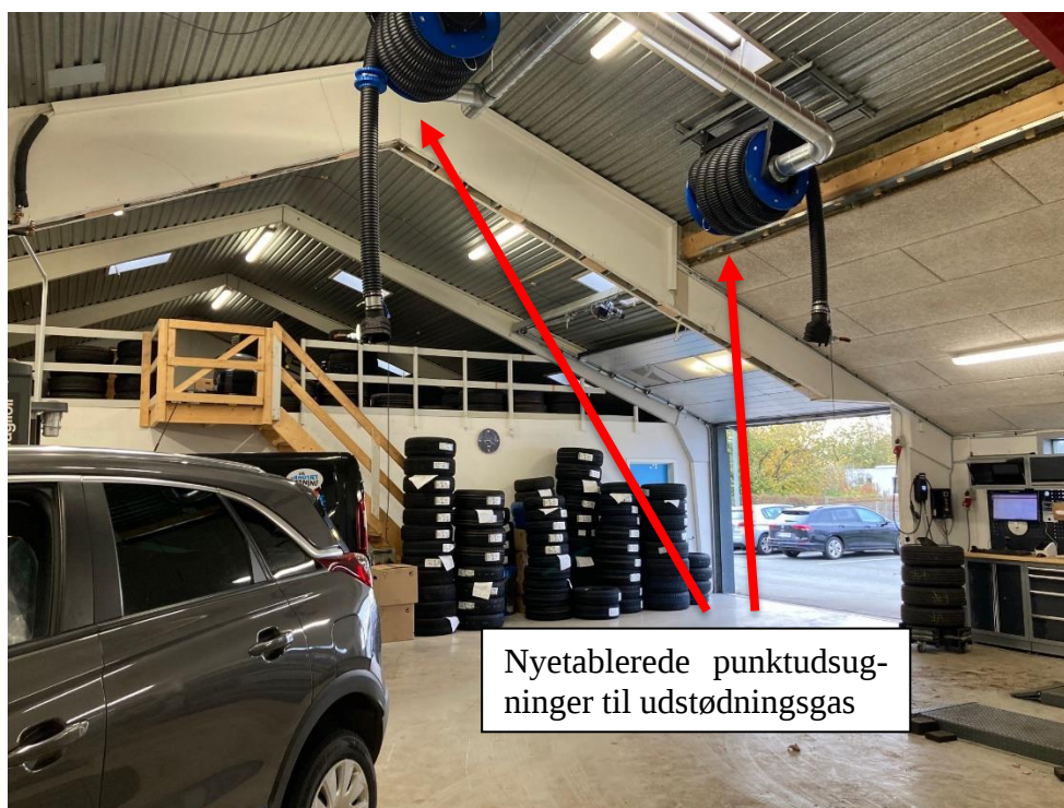
Nye punktudsugninger til udstødningsgas.
