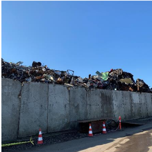
Nordlig mur, betonelementer til afgrænsning er knækket
