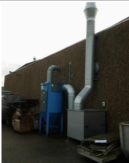
Nyt filteranlæg og afkast herfra
