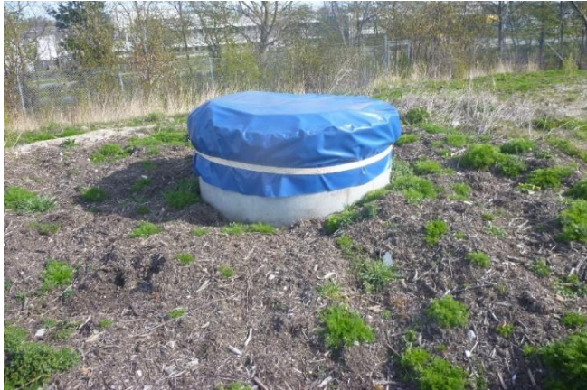
Foto 9: Omkring en perkolatbrønd er etableret biocover, og perkolatbrønden er tætnet med plast.
