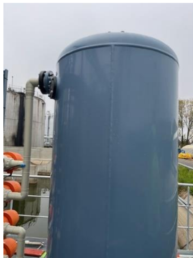
Nyt sandfilter på kulfilteranlæg tankgård
