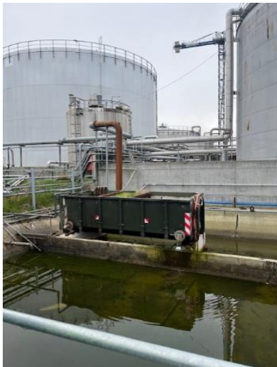
Halmfilter på kulfilteranlæg tankgård
