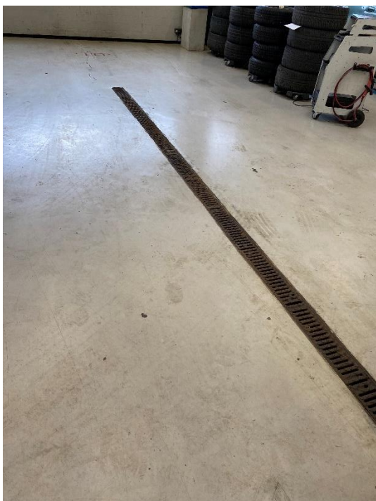
Gulv afløb i værksted
