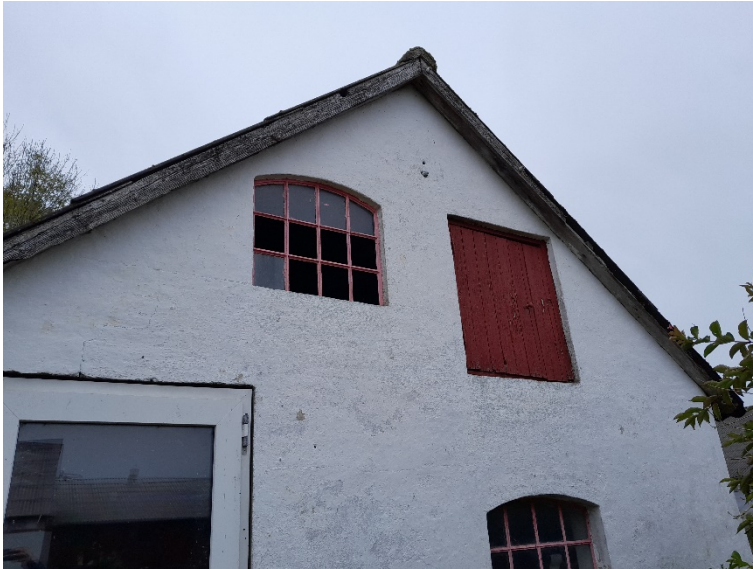
Figur 4 Foto af bygningens østlige facade. Vinduet i loftet mangler flere ruder.
