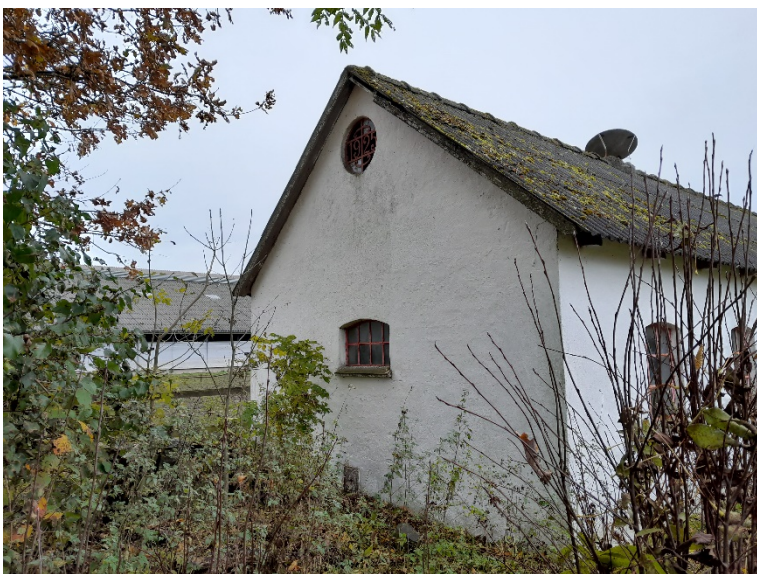
Figur 3 Foto af bygningens vestlige facade. Vinduet øverst mangler flere ruder.
