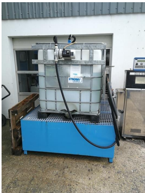
Billede 2. Oplag af AdBlue i palletank med spildbakke under.
