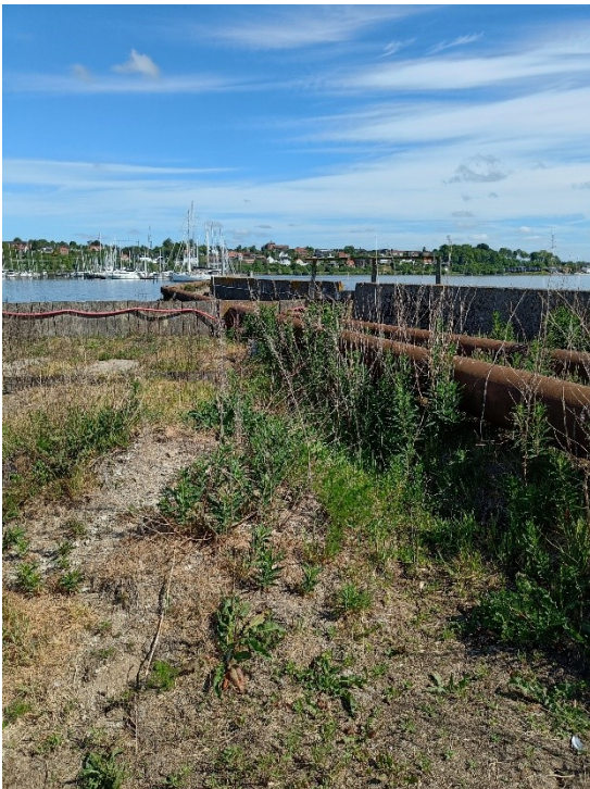
11. Indspulingsrør på deponiets nordlige del
