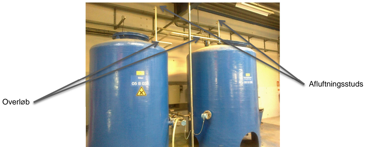
Overløbsfunktion og afluftningsstuds på lagerbeholder til henholdsvis silan og hærdekatalysator.
