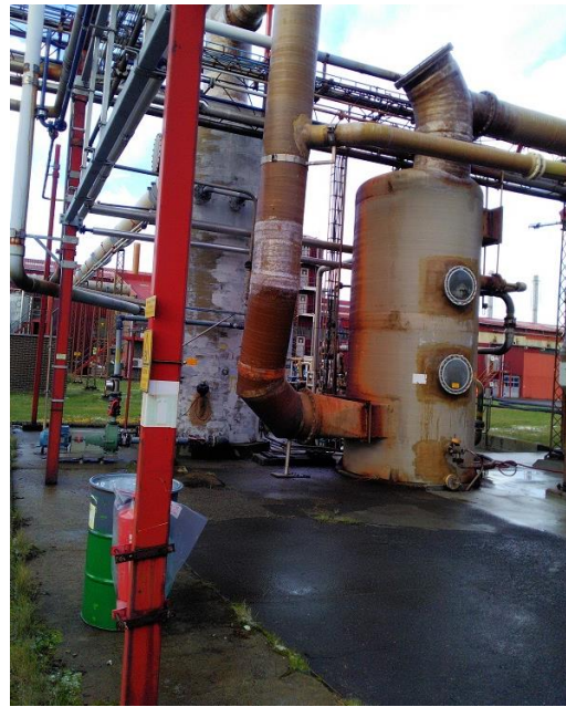
Billede 2. Skrubber på P2-området. Der er synlige skader og revner i belægningen.
