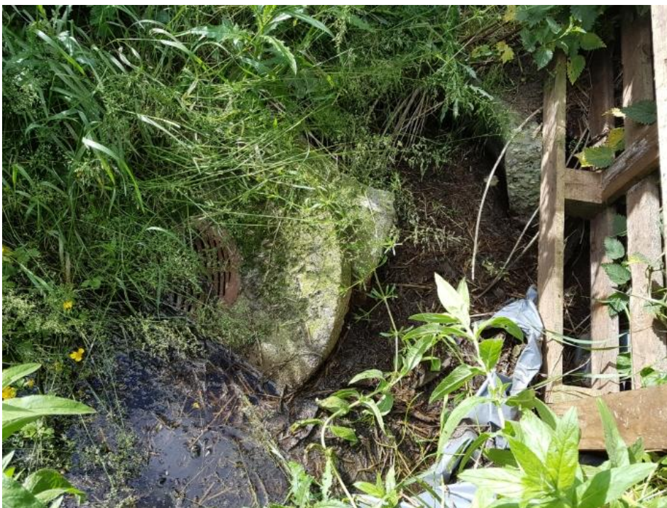
Figur 1: Gylle løber fra kalvehytter til denne brønd, som er gået i stykker.
