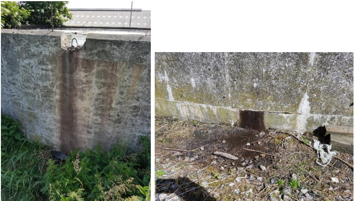
Figur 4: En del af beholderens øvre side er fjernet. Utætheder ved beholderens nedre del.
