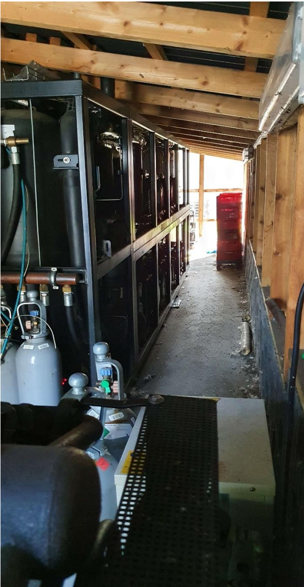
Skur til kompressorer (køl og trykluft) er åbent i den ene ende.
