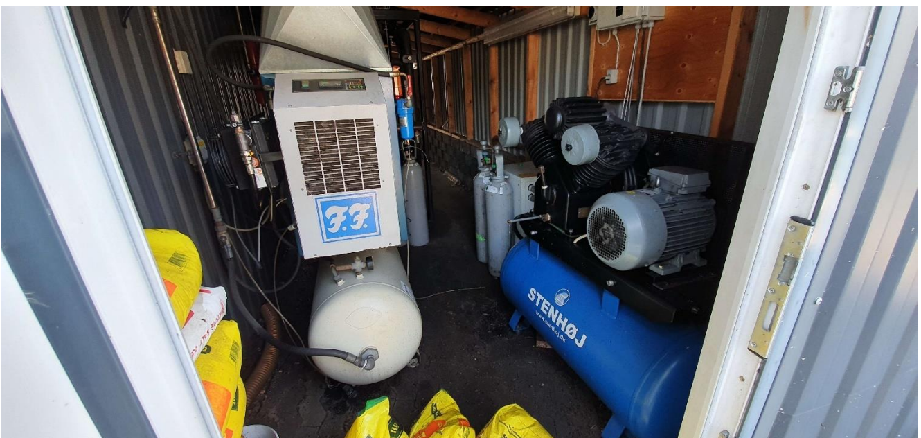
Trykluftkompressor i skur
