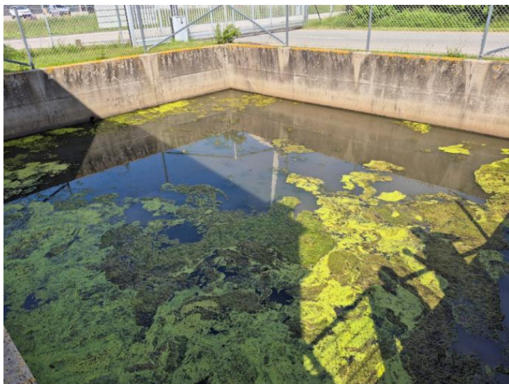
Billed 5. Opsamlingsbassinet ved indgangen til miljøanlægget
