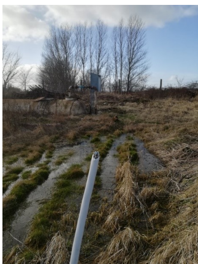
Foto nr. 1. Elkabel der forsyner perkolatpumpe med strøm er klippet over.
