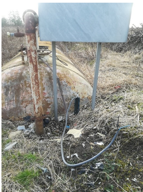
Foto nr. 2. Kabler til eltavle er kappet.
