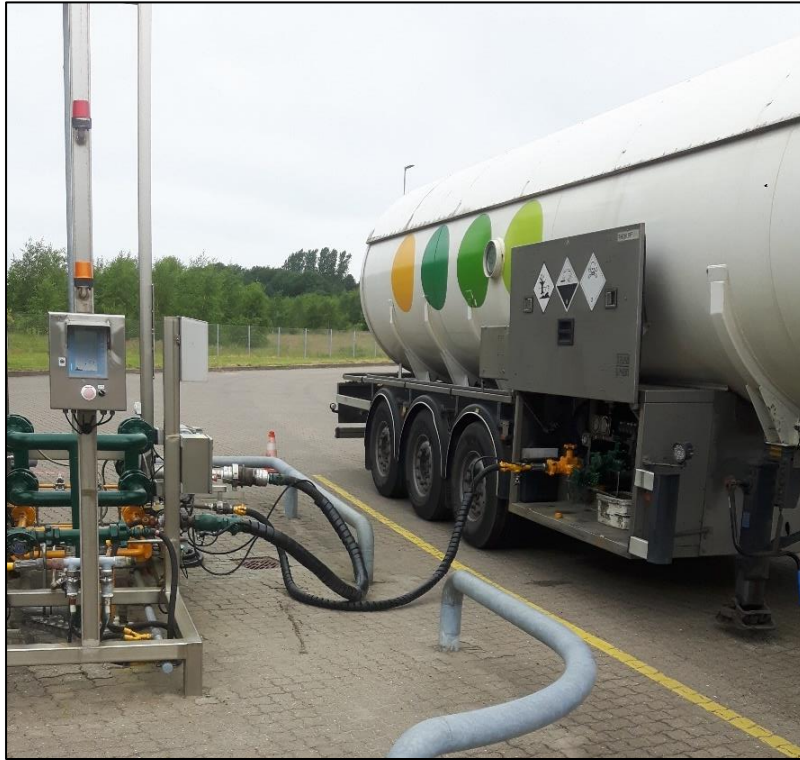
Figur 17 Ammoniaktankbil tilkoblet dispenseranlæg. Foto: WH-PlanAction.
