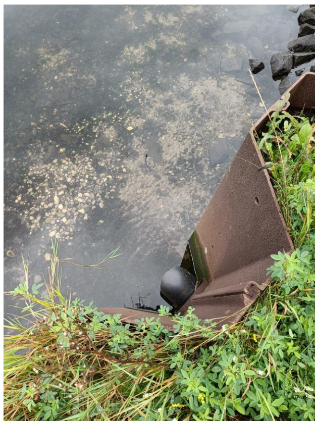
Billede 3.: Udløbsrør langs havbundssedimentdepotets østlige side.
