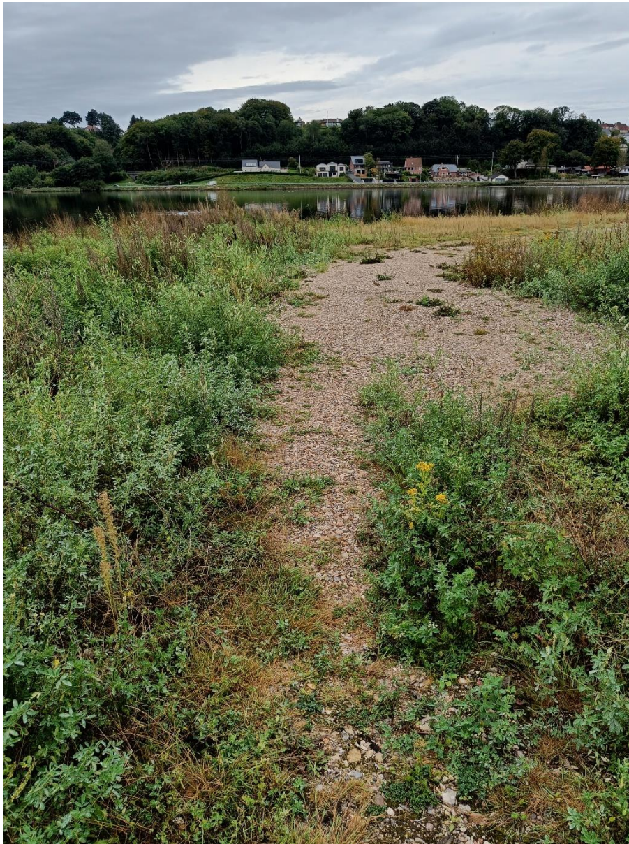
Billede 1.: Billede af deponiets sydøstlige hjørne med udbedring af kosmetisk skade på diget.
