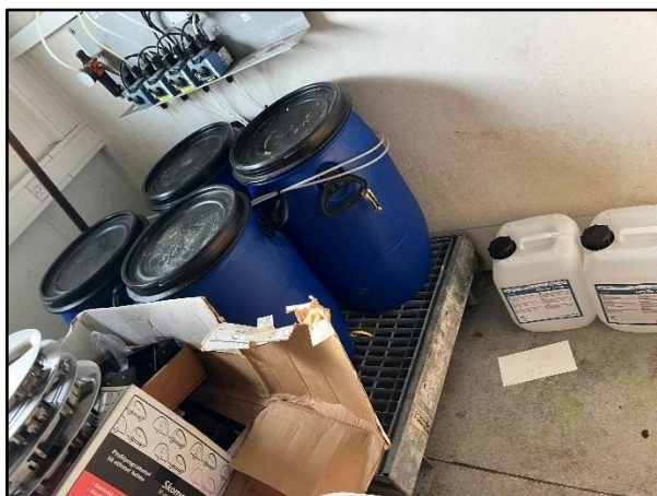
Vaskemidler til vaskehal i rum uden afløb
