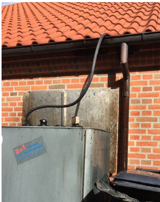
Pumpning af spildolie til spildolietank
