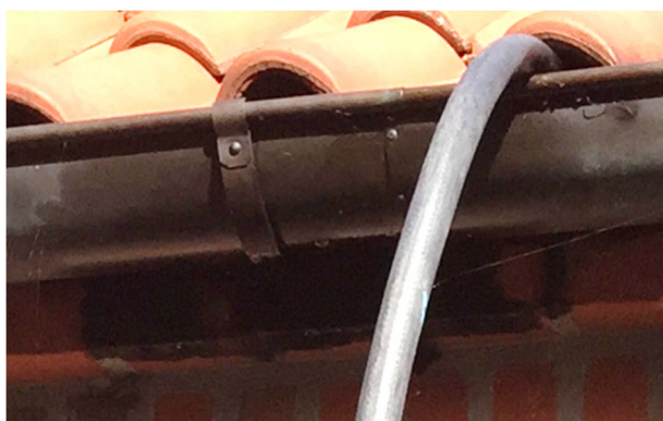
Plamager af spildolie på tagrende og mur
