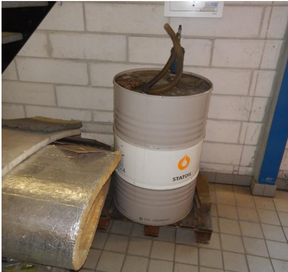
7. Tønde med hydraulikolie ved halmkedel.
