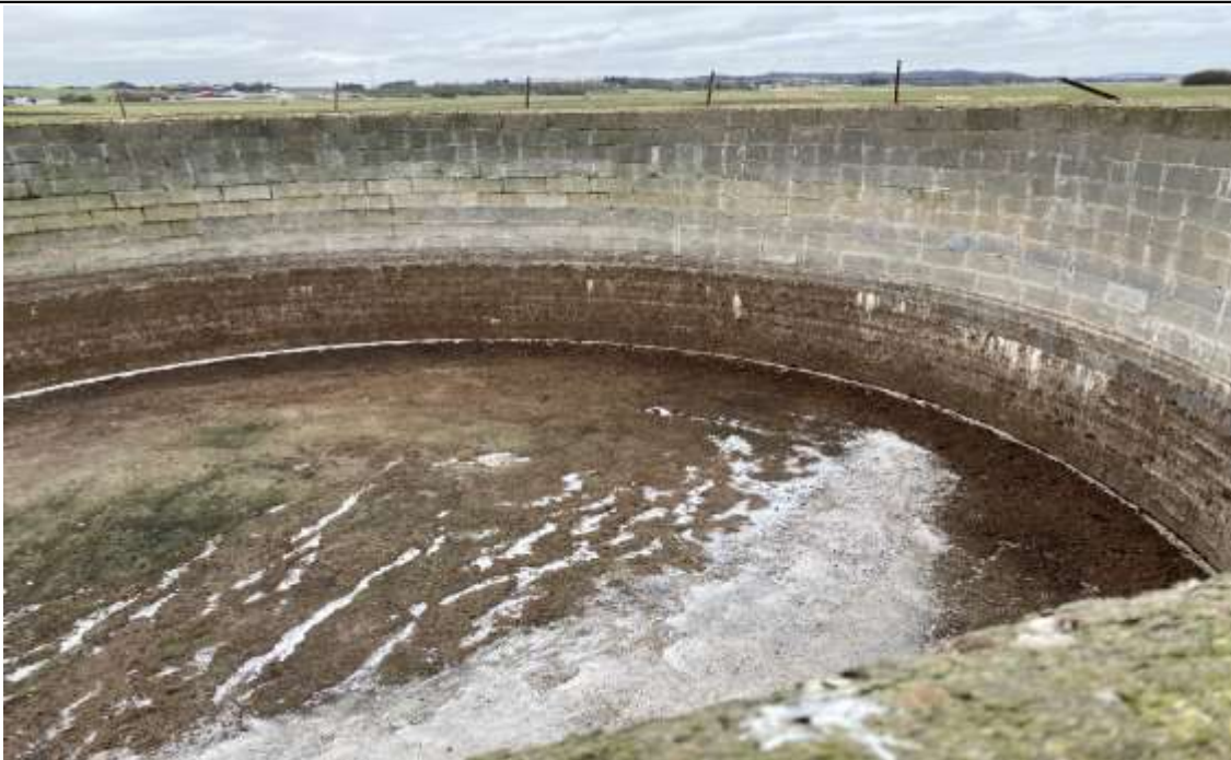
Mulige tegn på ny husdyrgødning op ad væggene i den lille gyllebeholder.
