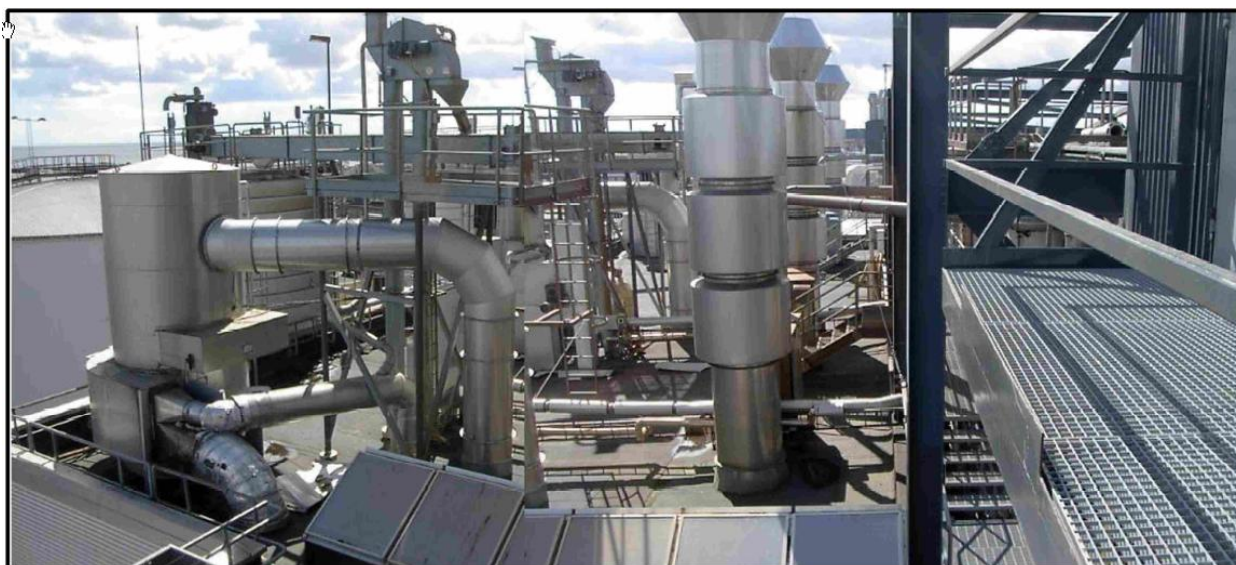
Diverse rør og udsugninger på tag
