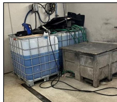
Sprinklervæske i vaskehal ved afløb
