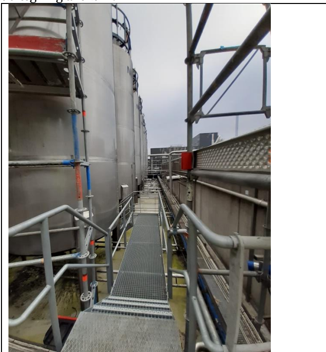
Tankgård med ethanol tanke og skumslukningsanlæg
