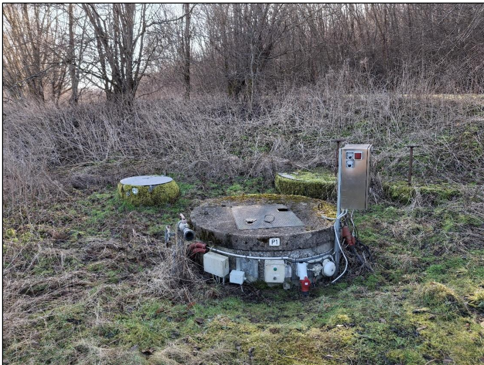
Foto 3: Samlebrønd P1 og PO, hvorfra hhv. perkolat og sekundært drænvand ledes til perkolatsamlekar forud for afledning til kommunalt renseanlæg.
