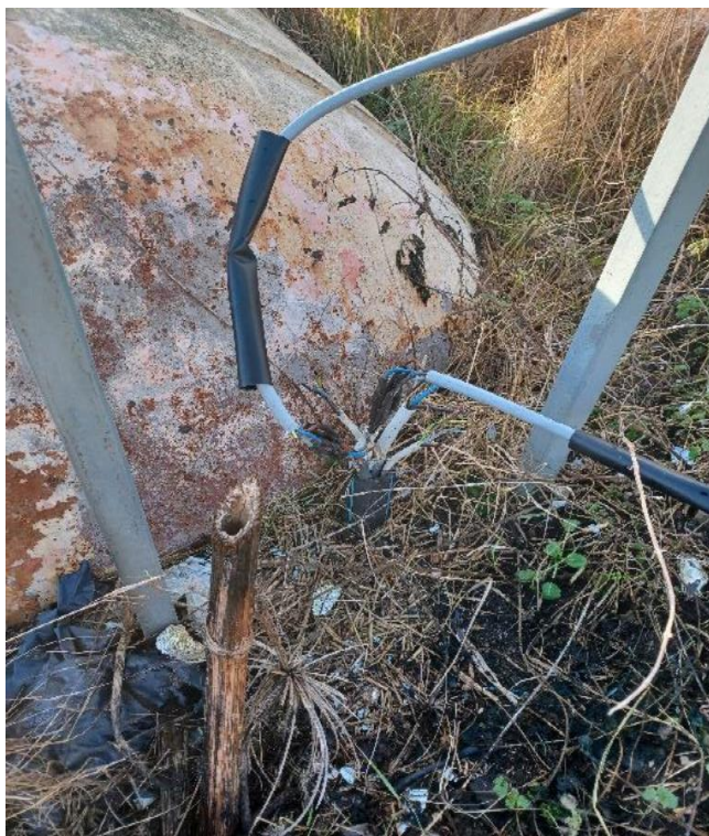
Billede 6 Overklippede ledninger ved tilsyn d. 3. januar 2023
