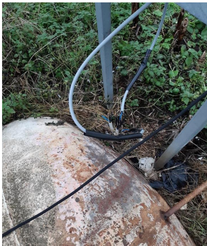
Billede 4 Overklippede ledninger til relæet, der styrer strømmen ved tilsynet d. 6. december 2022.
