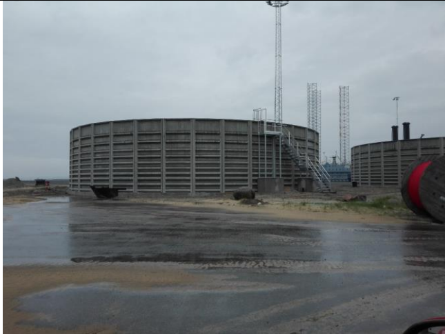
Buffertanke til overfladevand. Byggesag: BYG-2018- 06166
