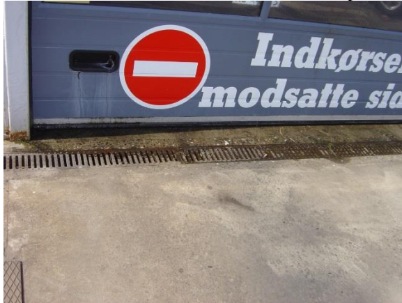
Afløbsrist udenfor vaskehal ved udkørselsport
