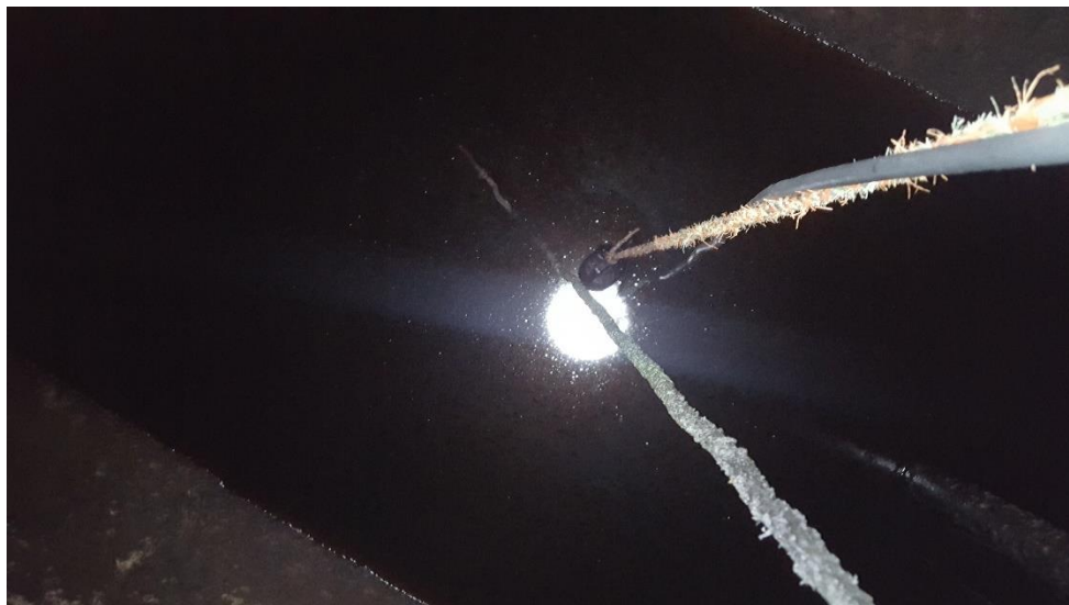
Billede 4 Der står vand i perkolattanken. Vandet pumpes op fra deponiet til tanken, hvorfra det føres til renseanlæg.
