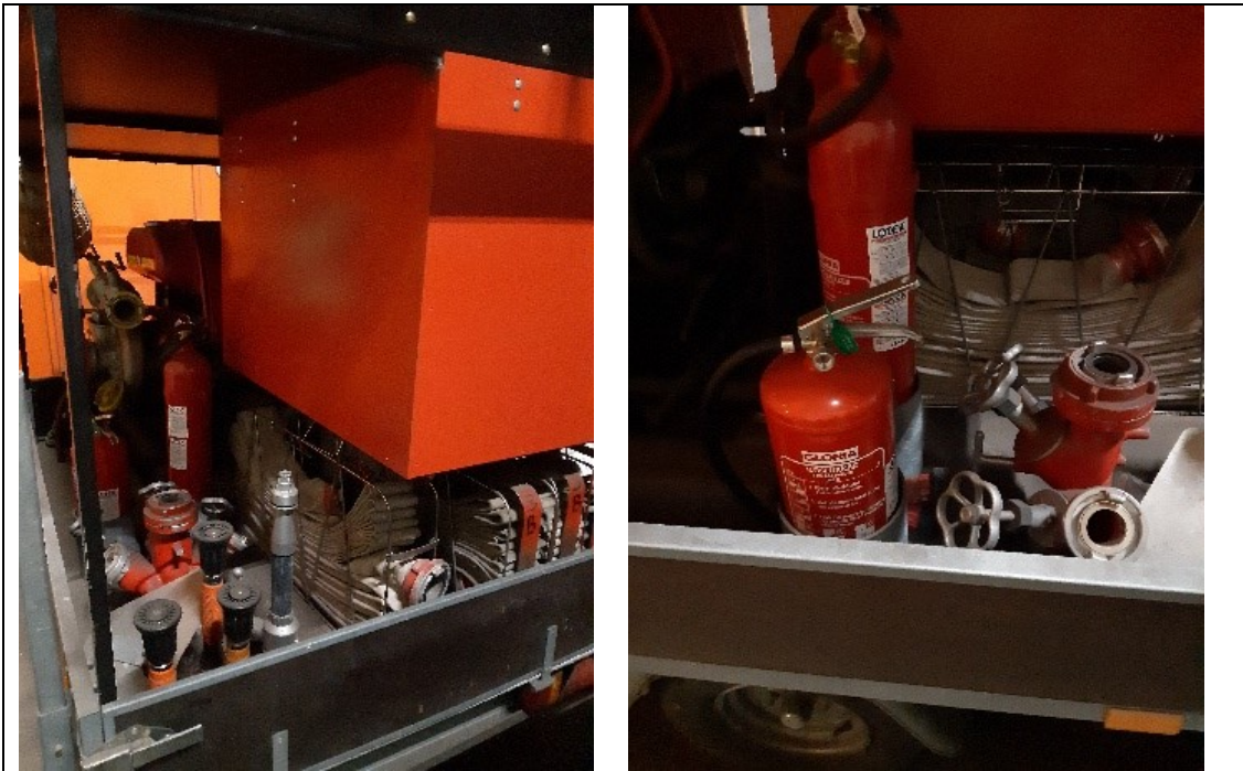
Brandslukningsanlæg er placeret inden døre i garage på en trailer.
