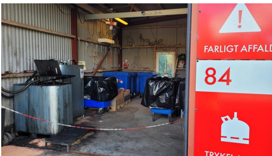
Sorteringshal til farligt affald, hvor der har været uheld ved spildolietanken til venstre
