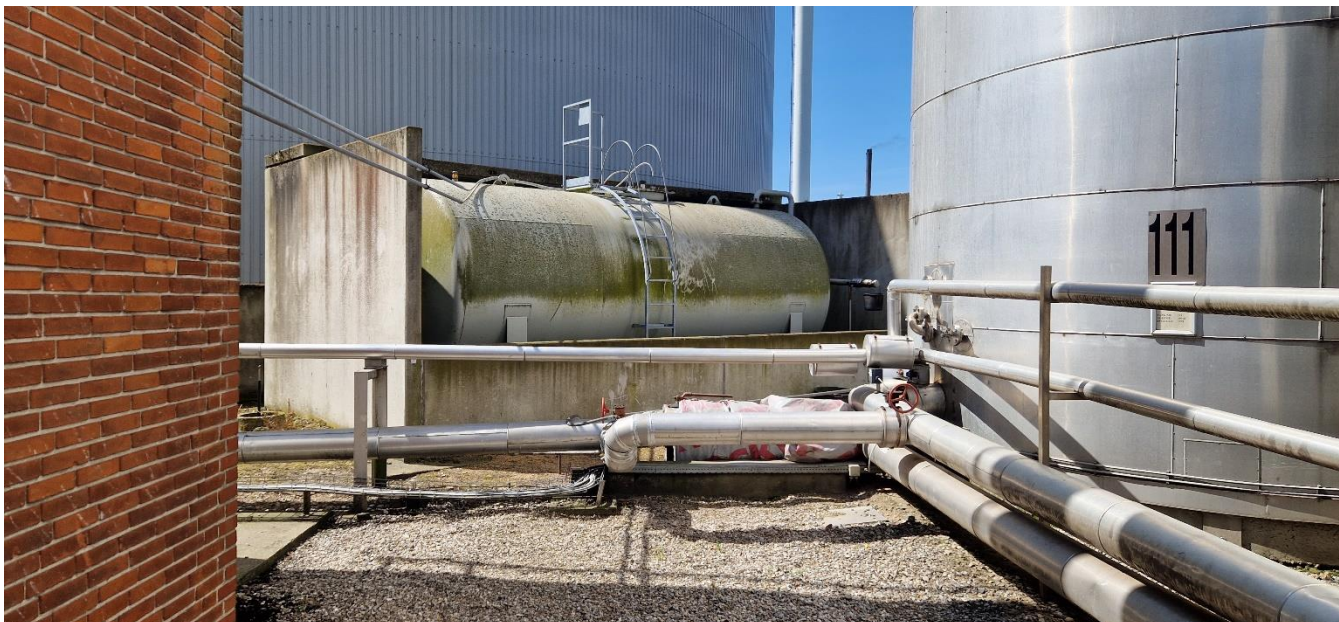
Olietank til kedelanlæg står i tankgård.
