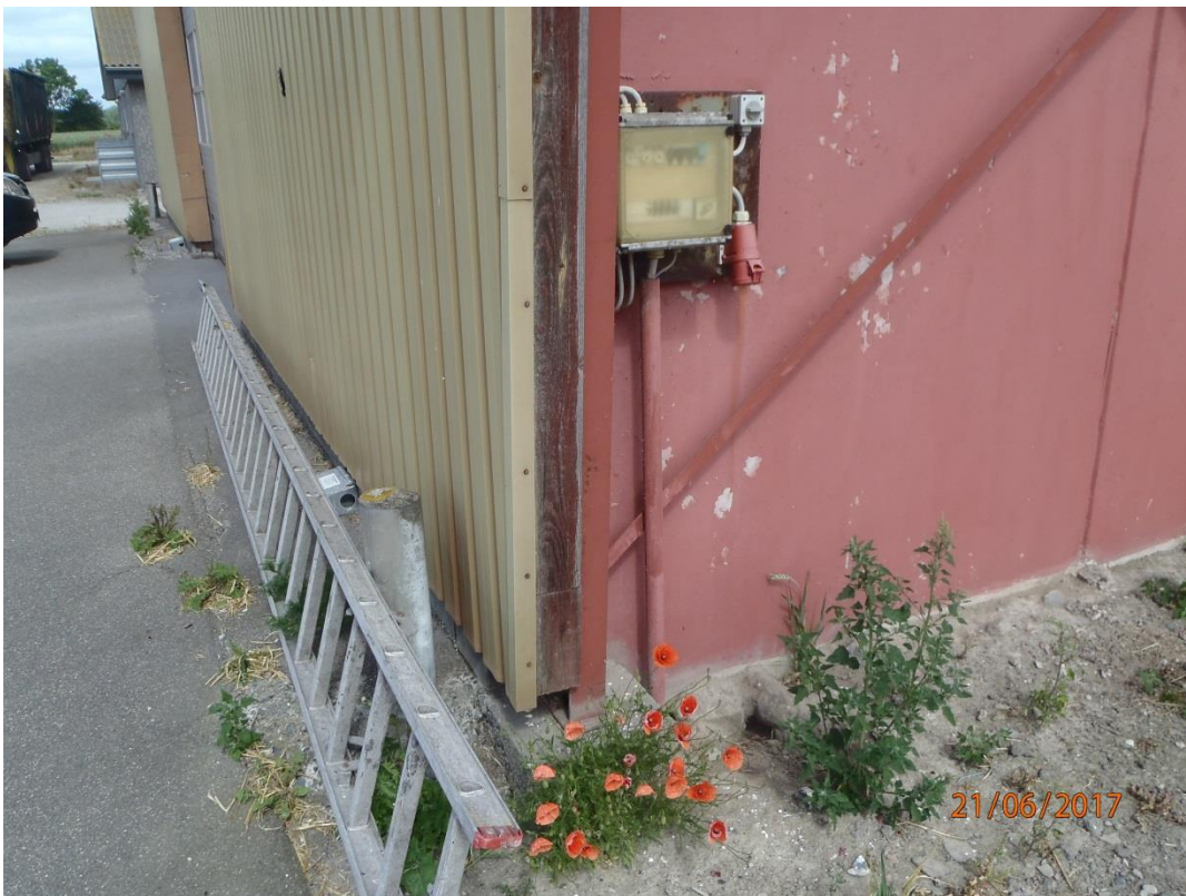
Billede viser rottehul på hjørnet ved siden af el- kablet.
