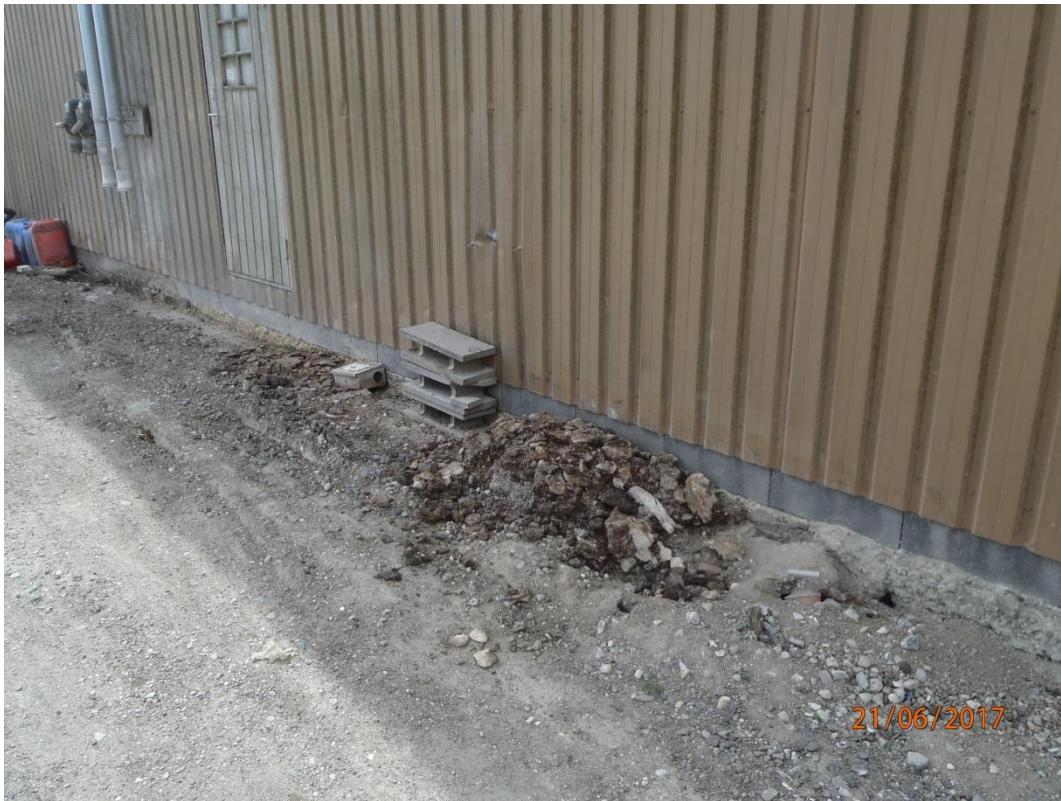
Billedet viser flere rottehuller
