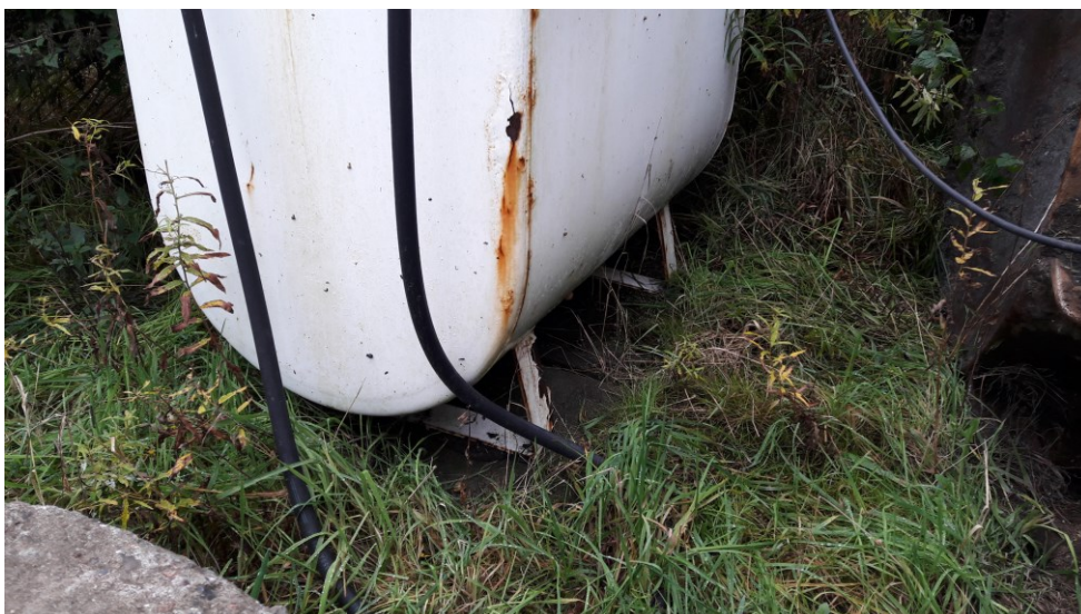
Tank 2. Transportabel olietank til diesel på jordkarteringspladsen. Tanken er placeret på betonfliser på membranbelagt areal.
