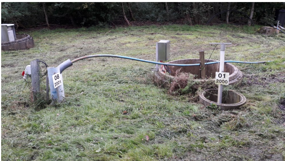
Fig. 10. Perkolatpumpebrønd på nedlukket etape. Der er installeret elektronisk pejleudstyr til måling af perkolatniveau. Systemet er knyttet til Favrskov forsynings SRO overvågningssystem.
