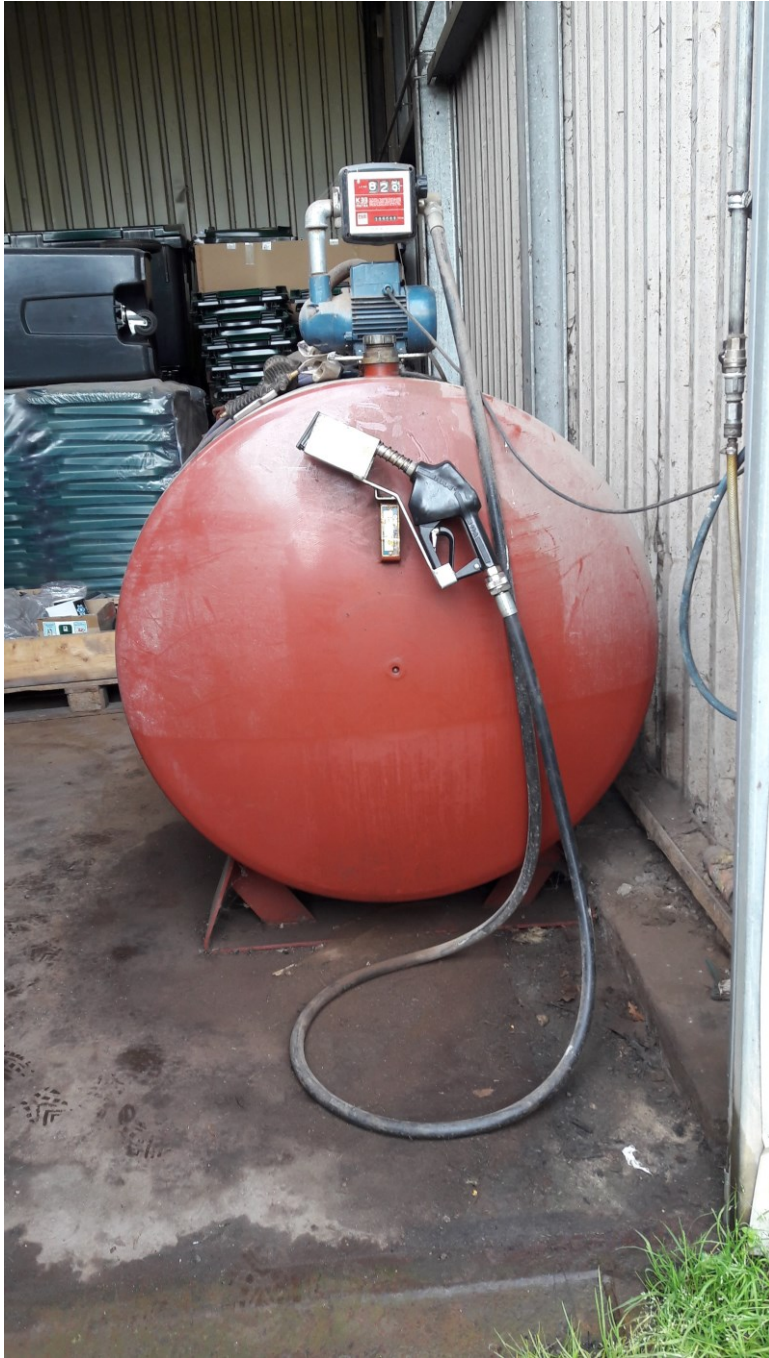
Tank 1. Overjordisk 4000 liter dieseltank i maskinhus. Der kunne konstateres spild fra tankning på gulvet. Der var ikke spildbakke under påfyldningsstedet ved tilsynet.
