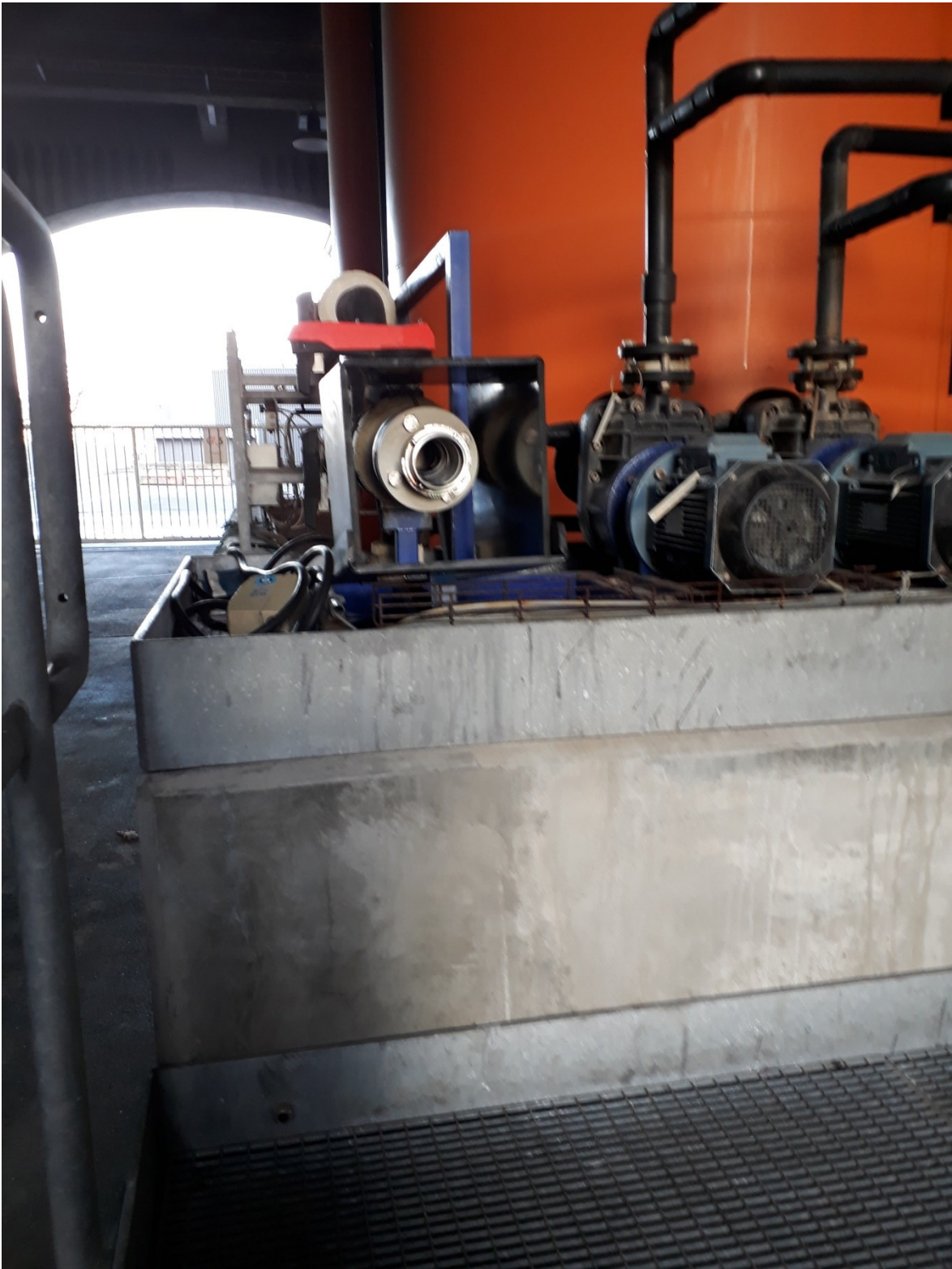
Bilag 3: Ventil til påfyldning af saltsyre til venstre og pumper til saltsyre til højre
