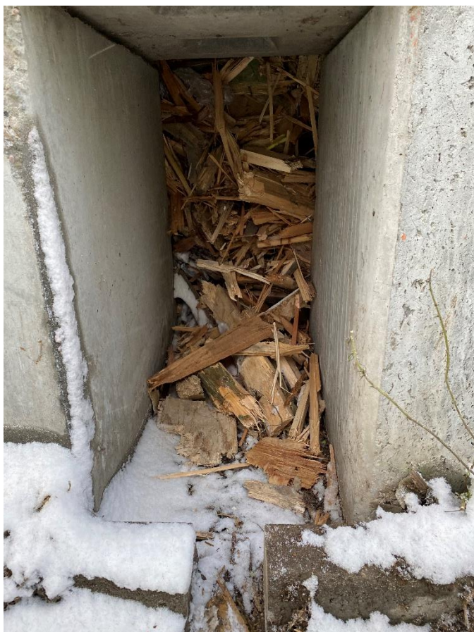
Figur 2: rende til afledning af overfladevand stoppet med træsplinter.
