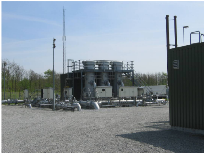
Figur 8.3 Filtre ved stationsmålebygning
