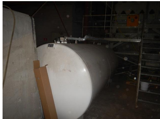
TA-10, Tank til fyringsolie til tørreanlæg
