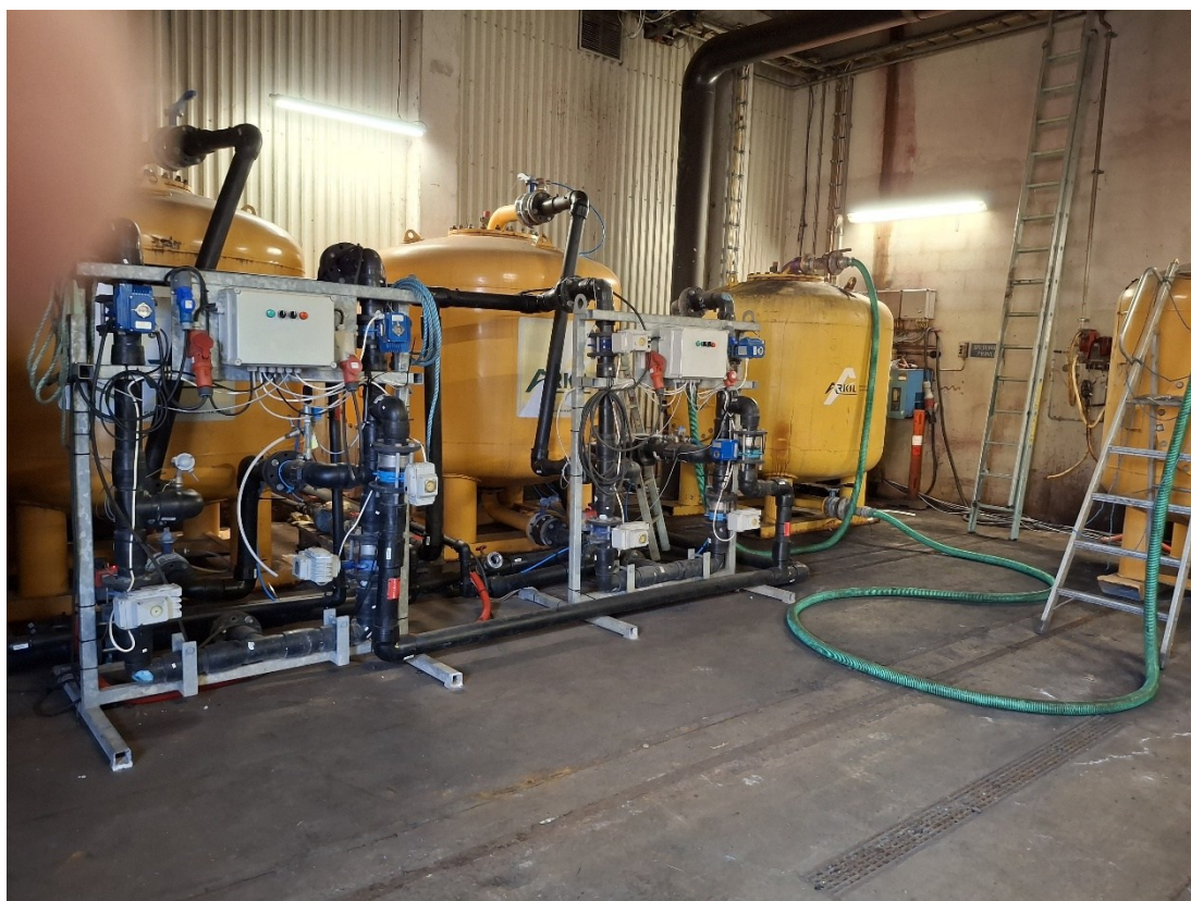
Foto 9 sandfiltre og kulfiltre
