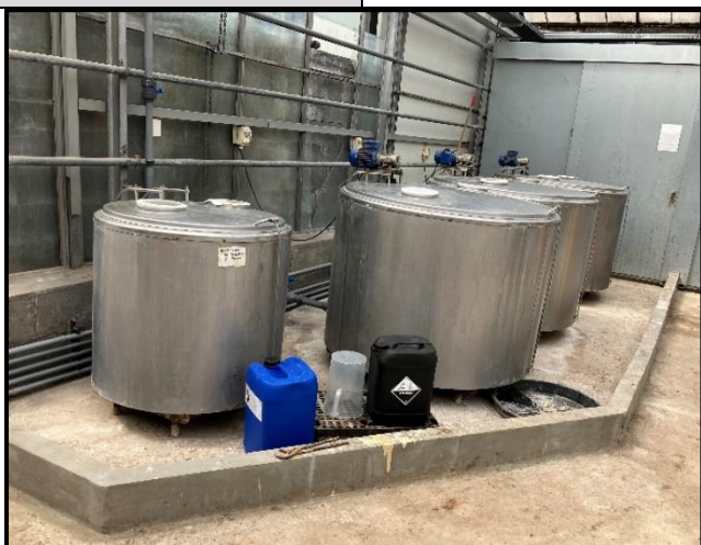
Opkant omkring kemikalier er repareret efter sidste tilsyn
