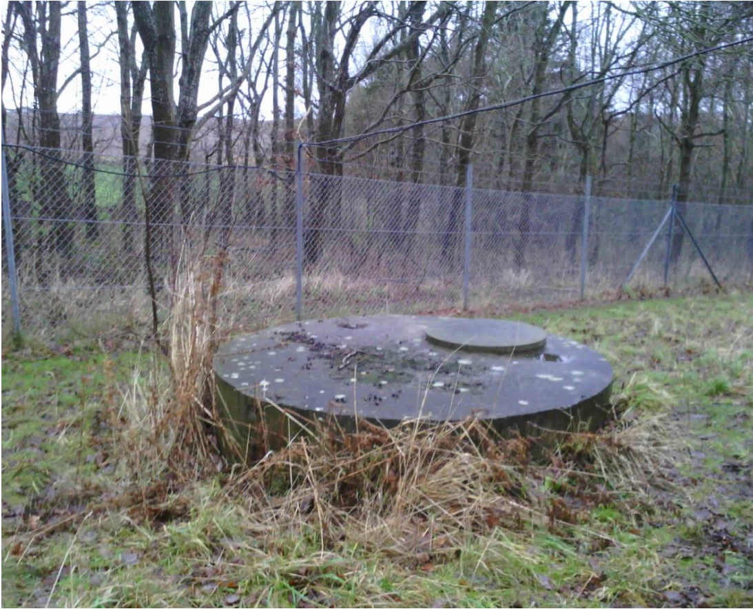
Opsamlingstank til vand fra brandslukningsplads
